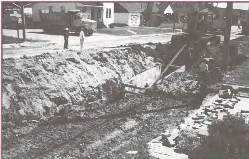
Travaux d'assainissement des eaux, en 1994, sur la route 101. Pose des tuyaux d'égout et du pluvial.
